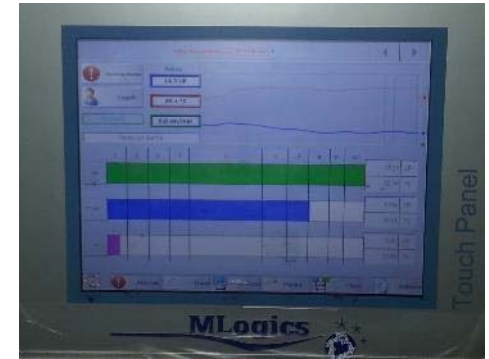
HMI del sistema control de un "Pasteurizador de Tunel"
