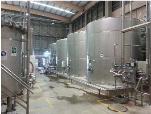
Tanques de guarda de Alcoholes administrados del sistema "BatchXpert"
