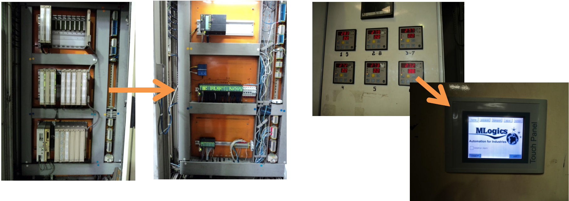
Reautomatización de Simatic S5 a Simatic S7
